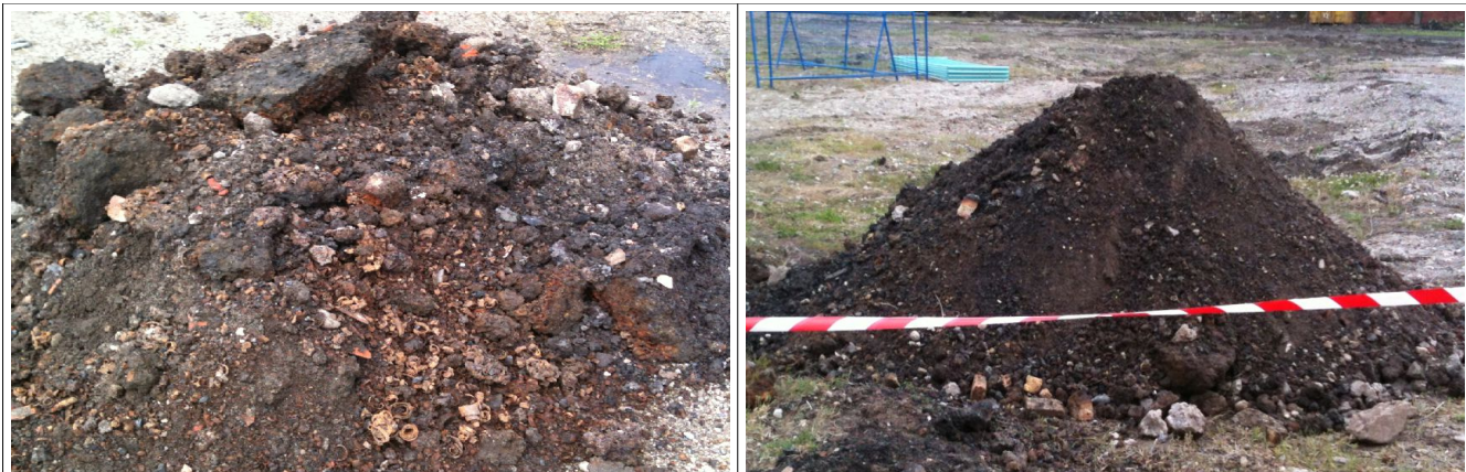
Vue sur les remblais contenant des résidus de fonderie, rencontrés localement au droit de la VNB4 Déblais réutilisés en remblaiement des tranchées au droit de la VNB4
